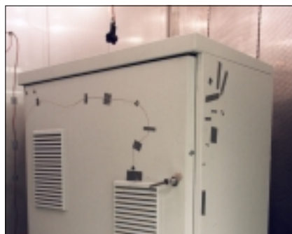
En radiobasstation från Ericsson Radio Systems.
